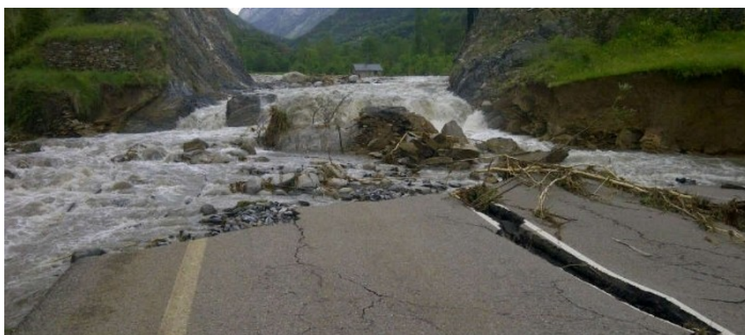
Figura 5. Estragos del Ésera en el siglo XXI. Carretera de Benasque a Cerler. Riada de 2013.
